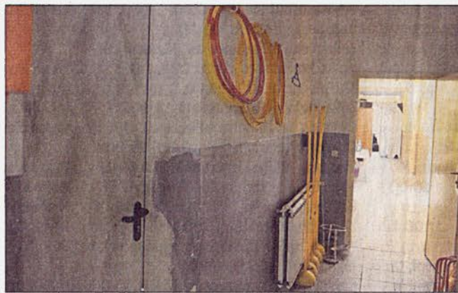
Das Innere des Funktionsgebäudes im Aue-Stadion offenbart erbärmliche Zustände, für die sich die SV-06-Leute schämen.
